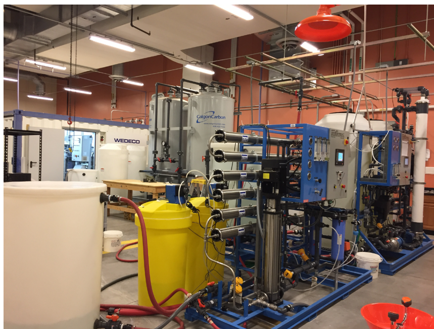
Figura 1. Sistema de filtración utilizado para aumentar la concentración de los contaminantes emergentes presentes en el agua tratada de la “Planta de recuperación de agua-Agua Nueva”.
