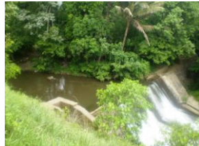
Sobre líneas, obras de protección de río. A la izquierda, ubicación de río y la parcela
